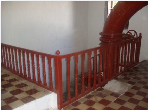
Detalle del pavimento de losetas hidráulicas, de 20 x 20, hechas de cemento, áridos y pigmentos (rojas y blancas), instaladas en la planta baja o sala de máquinas del edificio.
