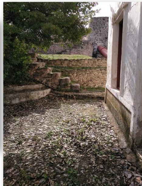
Empedrado con chinos de canto rodado de río sobre una capa de mortero de arena y cal, en el patio exterior circundante.
