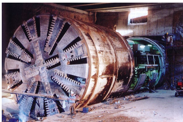
Figura 2: Escudo y “back-up” de la tuneladora “Almudena” en la estación de Puerta de Arganda en 1997. Fotografía publicada en la ROP [17].
