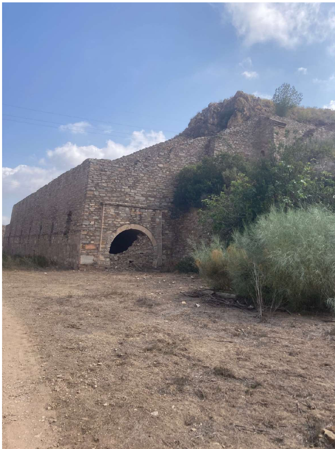
Estación de carga de Tres Amigos (2024)
