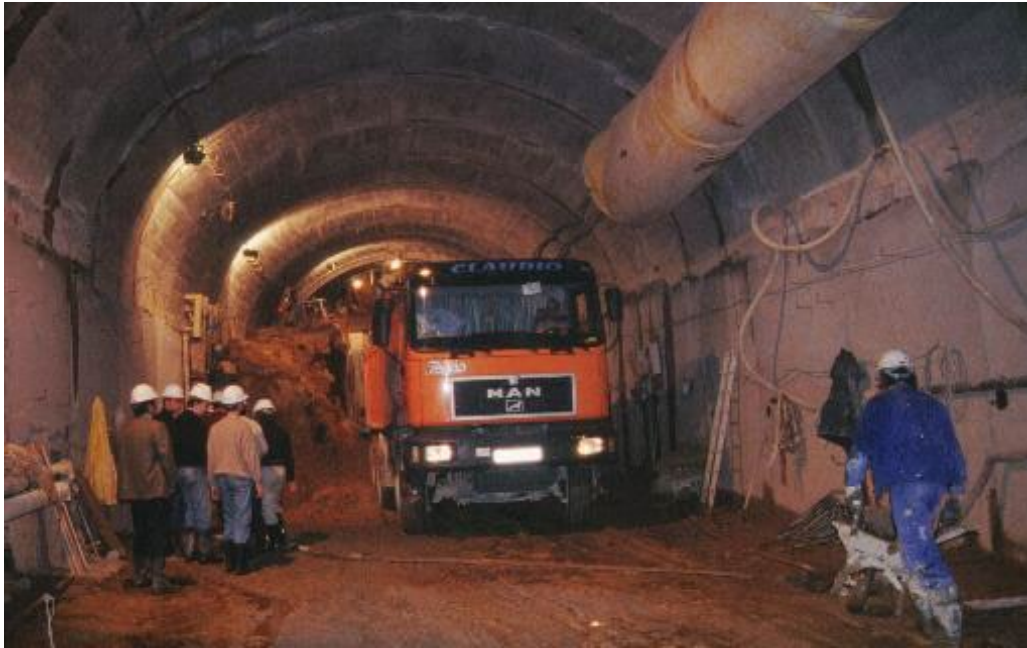
Figura 15: El grupo de visitantes (izquierda) avanzamos con los técnicos del Metro al frente de excavación para ver la ampliación de gálibo en el tramo Lago-Batán. Fotografía del autor.
