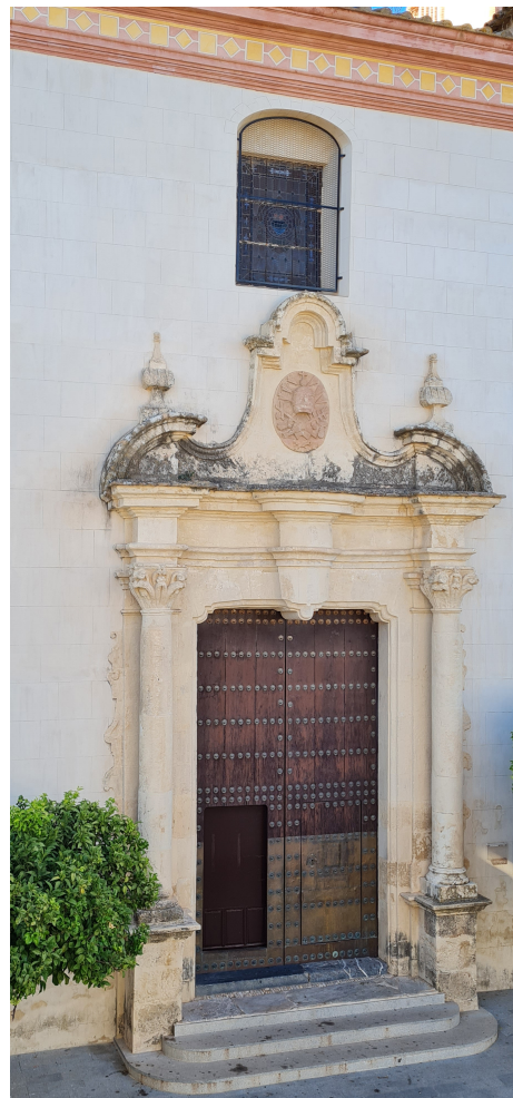
Lám. nº 3. Portada principal de acceso a la iglesia desde la Plaza Mayor. Fotografía: AMP.
